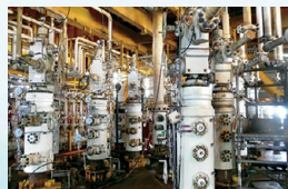
Устьевое оборудование и фонтанная арматура
